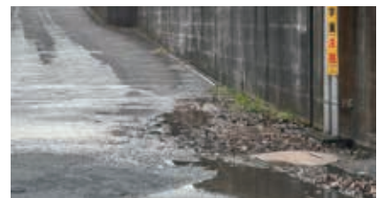
水が浸み出し凍結する東北道のアンダーパス
