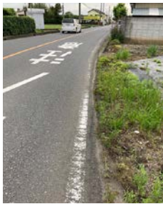
歩道が危険な 県道310号線
