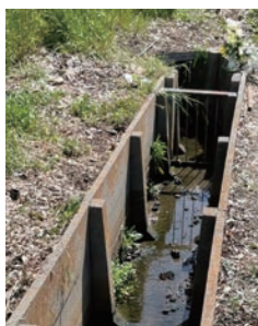
危険な農業用排水路
