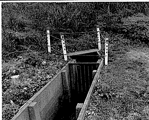
事故後に地元で鉄板を、市が杭とロープで応急処置を行いました。
